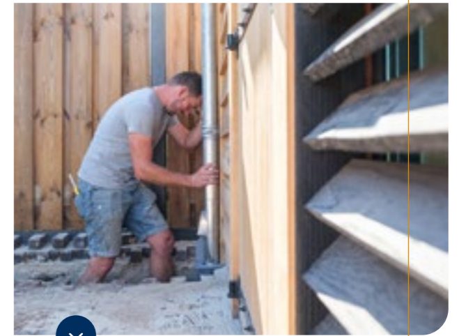
Regenwater in eigen tuin behouden door de afvoer van hemelwater aan te sluiten op infiltratiekratten.
